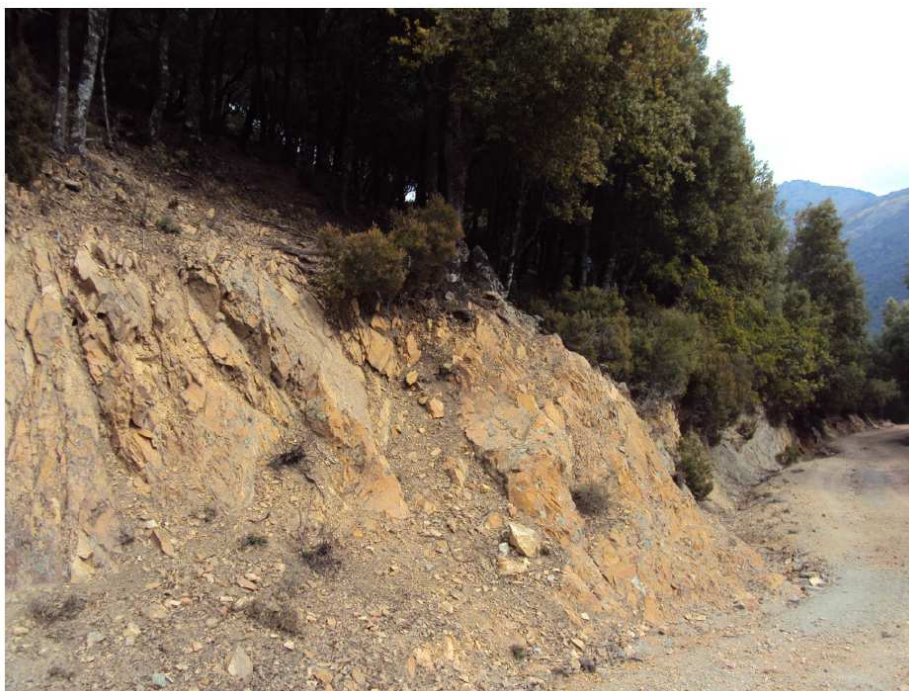
Figura 4.11 Piccolo smottamento del terreno lungo il tracciato n. 18 (S.F. 123/1)
