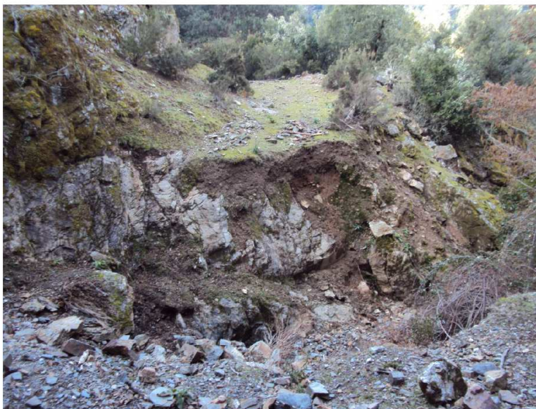
Figura 4.10 per scivolamento e scoscendimento lungo il tracciato n. 21 (S.F. 84/1)
